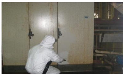
Nettoyage de portes extérieures d'une armoire électrique
